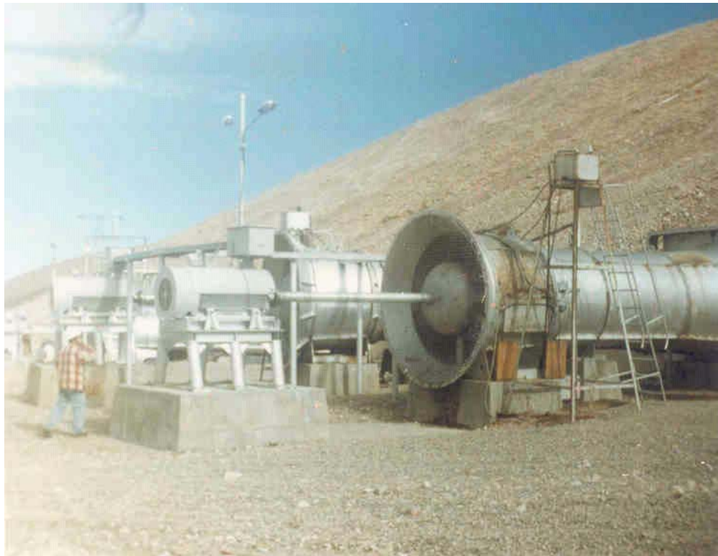
Ventiladores tipo Axial
